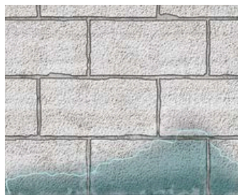
Atención de humedades
